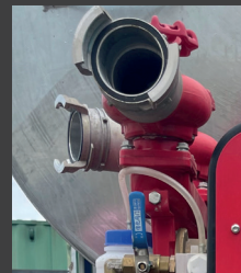
Anschlüsse und Ventile
