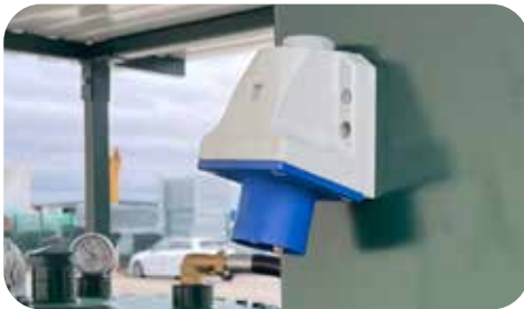
220V-Außensteckdose für den Gesamtanschluss
