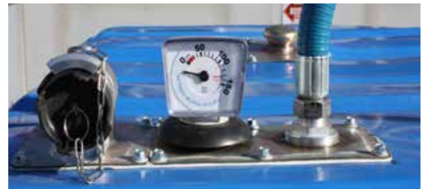
Füllstandsanzeige und Füllanschluss
